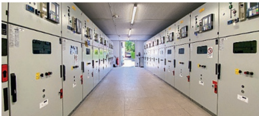
Die neue Schaltstation „B3“ wurde erst 2024 errichtet und ist mit neuester Technik ausgestattet.
