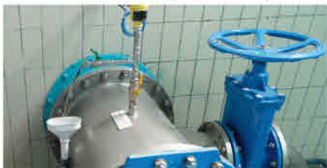
An der Entnahmestation werden regelmäßig Wasserproben zur Kontrolle der Qualität genommen.
