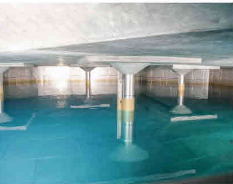
Im Wassertiefbehälter aus Edelstahl wird das Neu-Isenburger Trinkwasser gesammelt.
